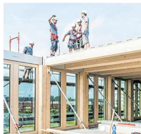
35 Arbeiter waren in den zehn Tagen bis zum Richtfest auf der Baustelle beschäftigt.
